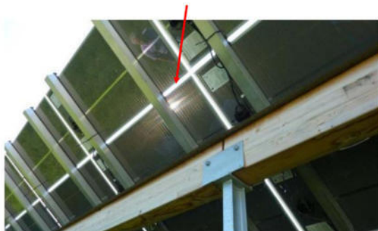
Abb. 26: Wasserablauf zwischen den Modulen durch Abstände
