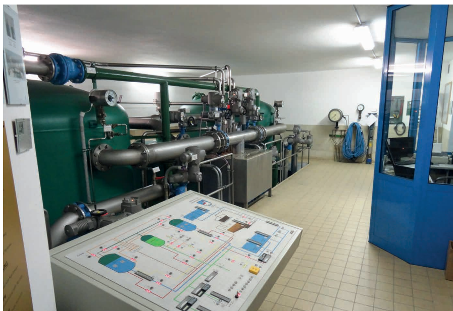
Der Arbeitsplatz von Stefan Demuth – die Wasseraufbereitungsanlage in der Badstraße
