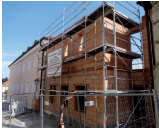
Das ehemalige Brodingerhaus ist abgerissen. Der Neubau nimmt Formen an und soll bis 2019 fertiggestellt sein.
