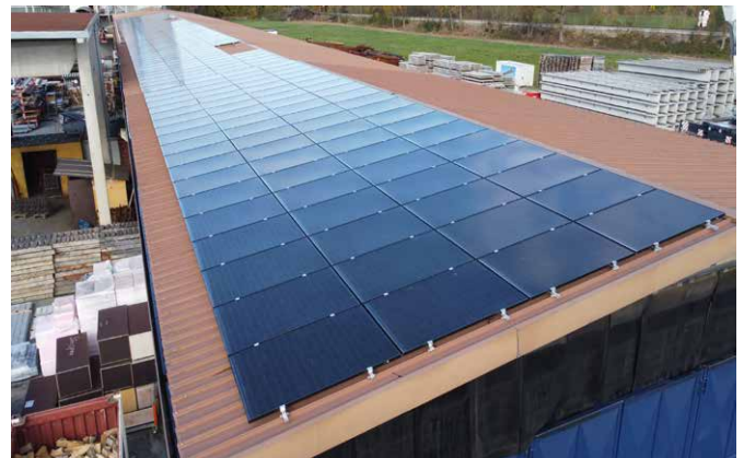
Das Werksgelände in Penning mit der neu installierten Photovoltaikanlage.
